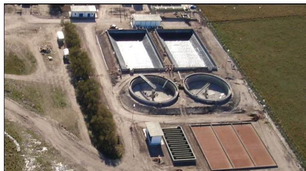
Figura 4. Vista Panorámica de la Planta Depuradora.
