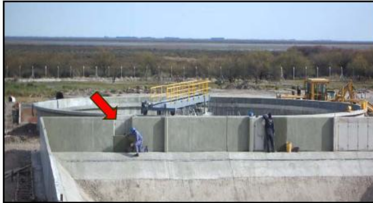
Figura 8. Vertedero rectangular en la salida de la cámara reactiva.
