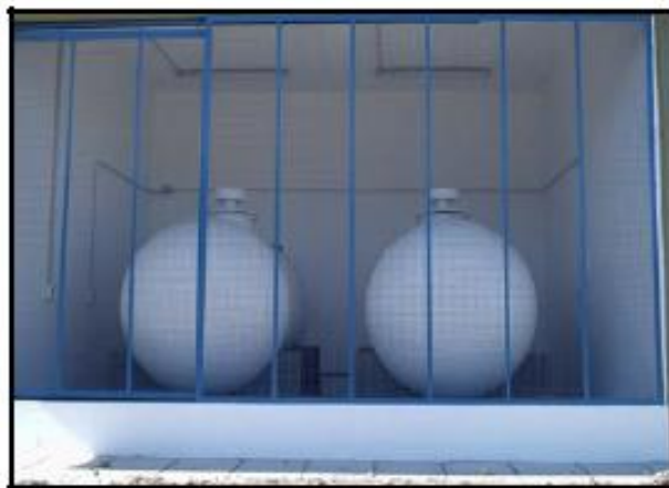
Figura 14. Tanques para contener cloro
