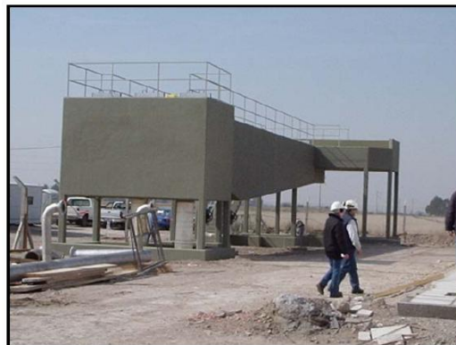
Figura 6. Vista general del Desarenador.
