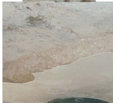
Figura 9. Inspeção visual na face inferior da laje em estudo: causas intrínsecas
