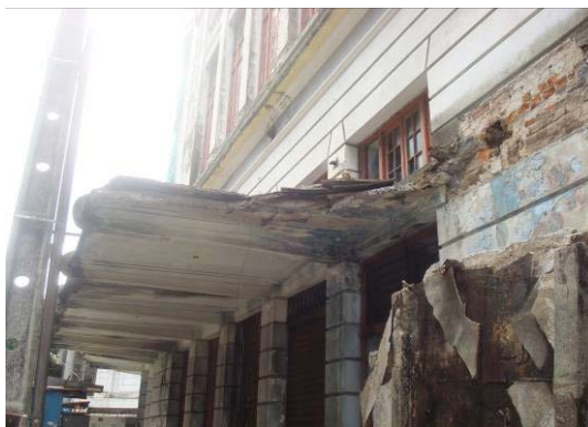
Foto 10 - Trecho da Marquise que colapsou
