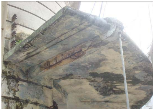
Foto 11 - Consolo CO1 com armaduras corroídas e Lajes L1 e L2 fissuradas apresentando infiltração generalizada
