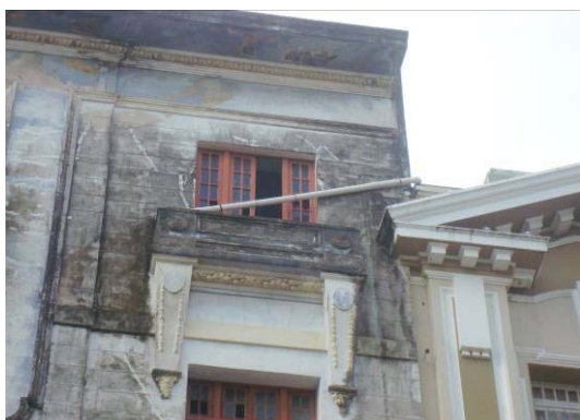
Foto 12 - Tubulação de deposição de águas pluviais sob a marquise
