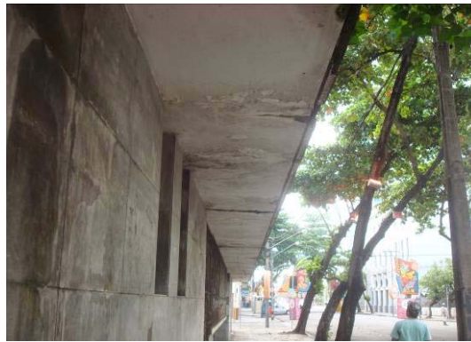
Foto 01 - Vista lateral da M01
