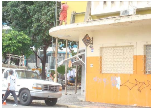
Foto 08 - Escoramento incorreto da M03
