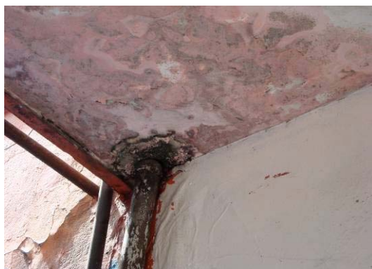
Foto 04 - Tubulação de drenagem e manchas de umidade da M02
