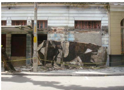
Foto 09 - Colapso parcial de marquise no Centro histórico do Recife
