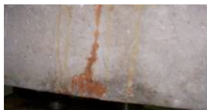
Viga corroída durante 90 días
