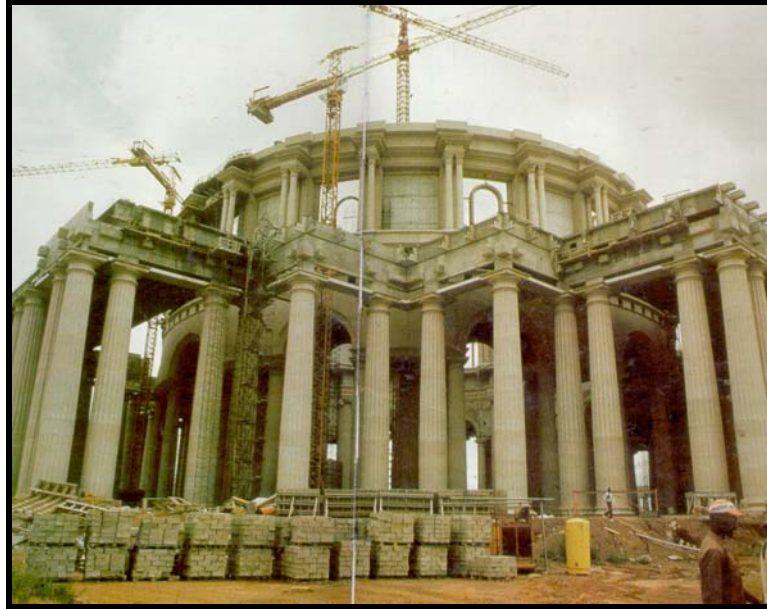
Figura 11: Processo construtivo da basílica de Nossa Senhora da Paz na Costa do Marfim, África [1]
