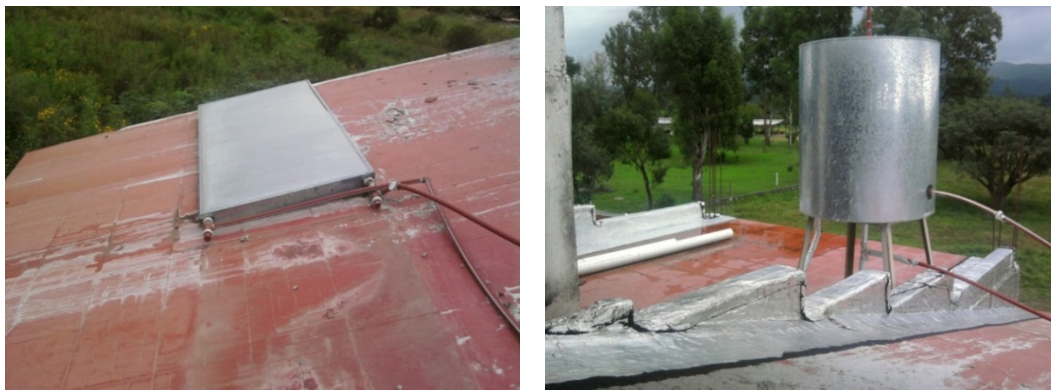
Figura 12: Colector solar y acumulador de agua instalado.
