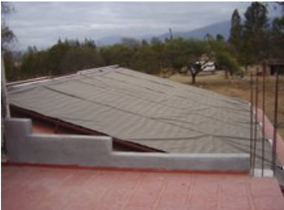
Figura 6: Bolsa negra para calefacción solar de piscina.
