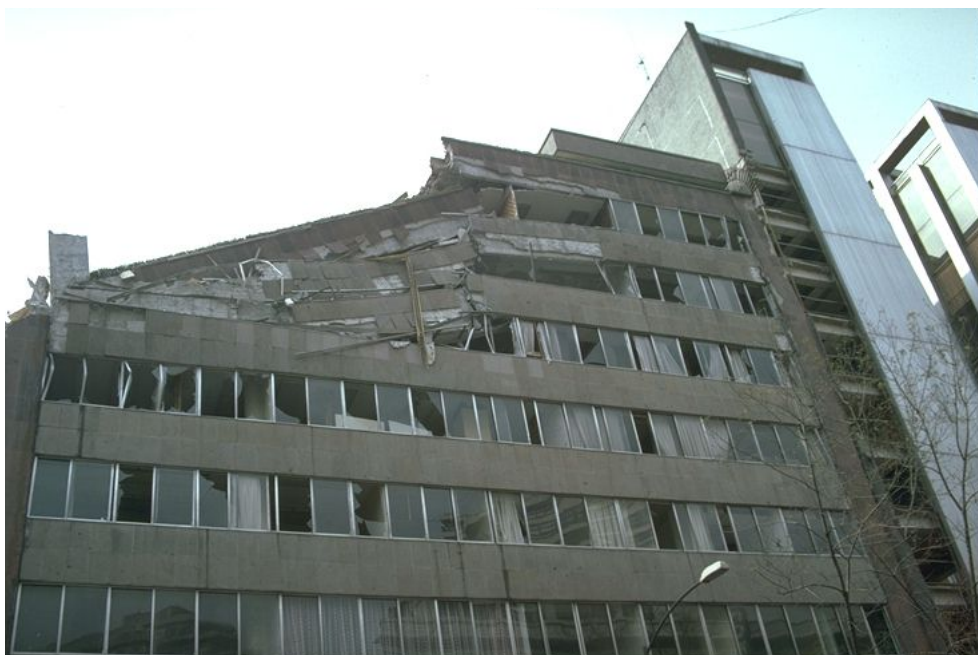
Figura 1.1.- Edificio colapsado en la Ciudad de México.
