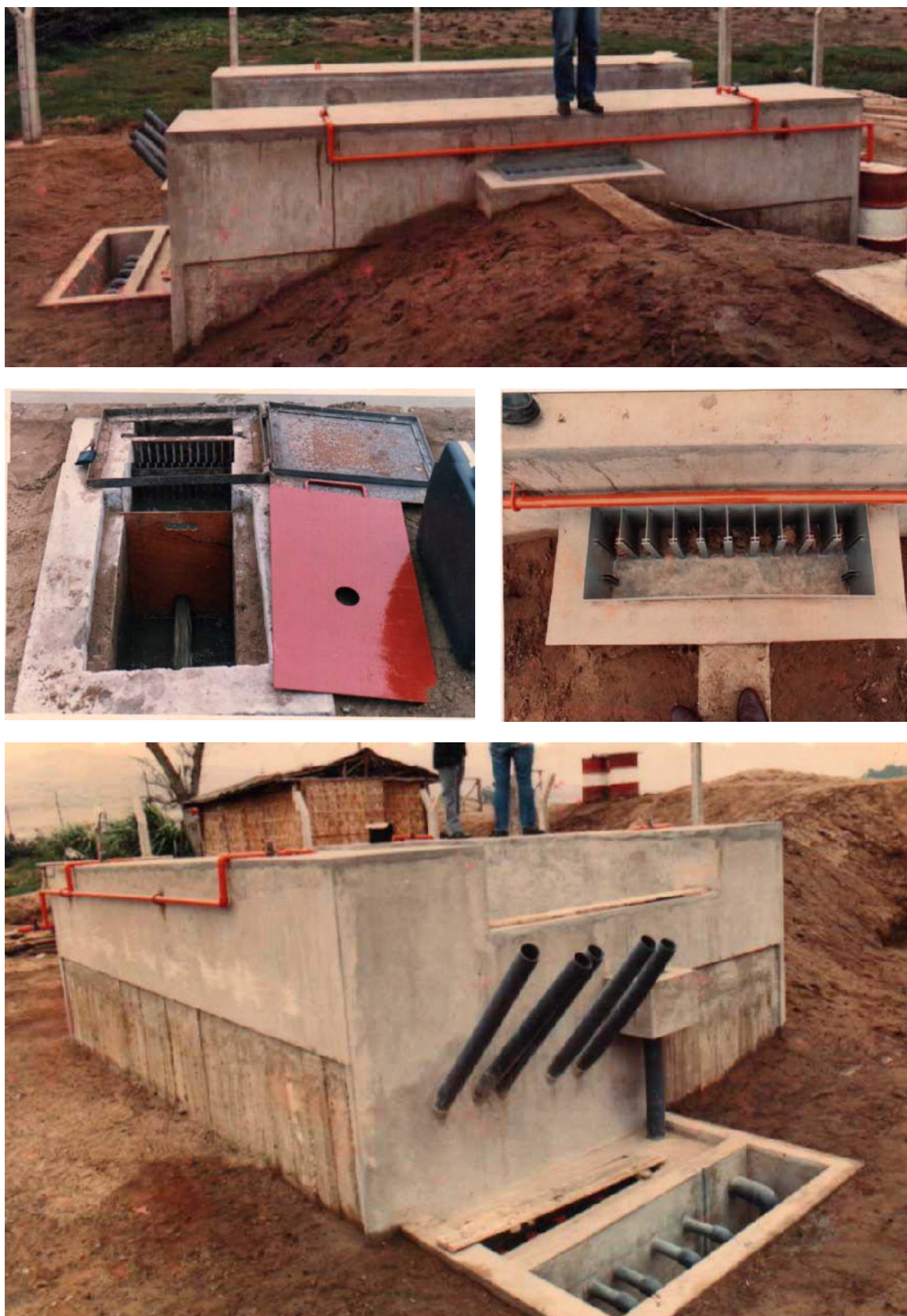
FIGURA 31: FOTOS DE REACTOR UASB
