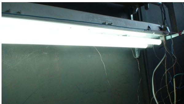
Fig. 2 - Lâmpadas tubulares montadas na luminária utilizada e sem o refrator (aberta).
