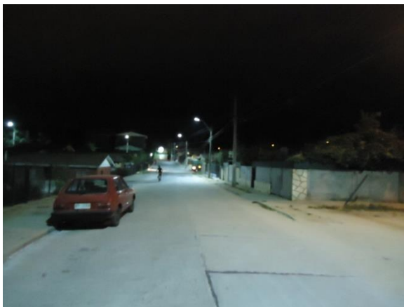
Fig. 2: Iluminación San Jorge con LED
