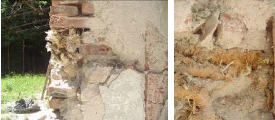
Figura 24 y Figura 25: Lateral del muro colapsado
